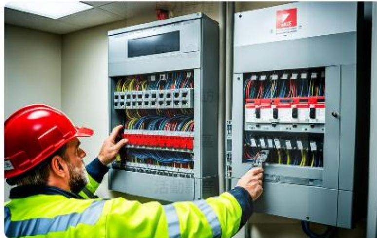
機電、消防維護.jpg
